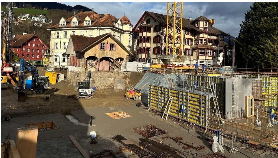
Die Betonpfähle sind versetzt und Teile der Bodenplatte fertig betoniert. Die ersten Seitenwände sind ebenfalls hochgezogen.
